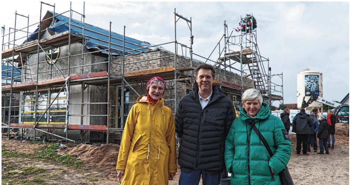
Präsidentin des DRK-Kreisverbandes Carén Krebs (links), Ulf Kienast vom DRK-Kreisverband und Stadtpräsidentin Anna-Katharina Schättiger auf der Baustelle der Kita „Flinke Fööt“. Sie teilen ihre Begeisterung, dass der Betrieb in der neuen Kindertagesstätte im Juni beginnen soll.
